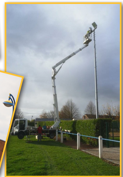
Éclairage LEDs au stade
